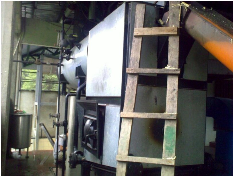
Ilustración 16 Caldera en la planta de beneficio.
