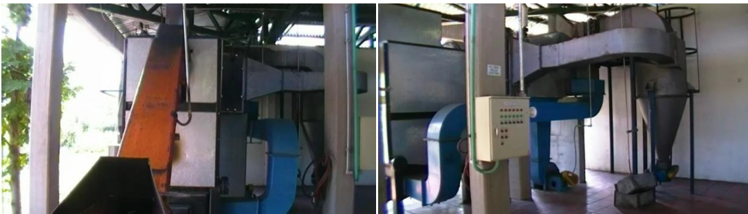
Ilustración 27 Caldera acuotubular para producción de panela
