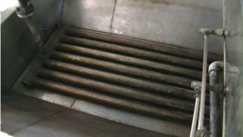
Ilustración 20 Sistema de tubería que transfiere el calor del vapor al jugo de caña.
