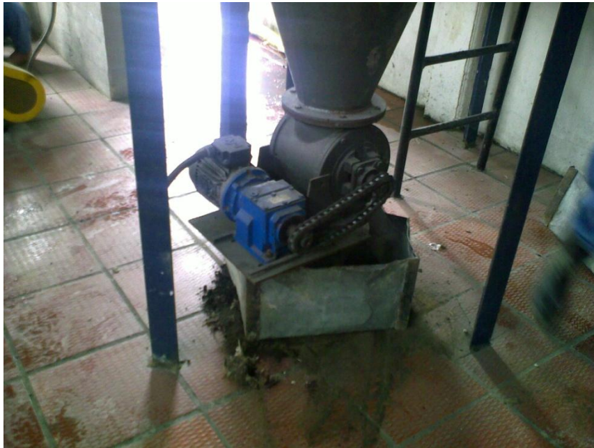
Ilustración 19 Sistema de Ciclón para limpieza de gases emitidos
