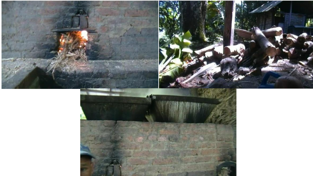
Ilustración 9. Bagazo, leña y otros combustibles utilizados en la evaporación. Debido a la distribución de las pailas, se hace necesario la utilización de dos cámaras de combustión.
