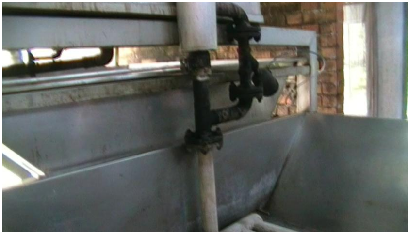
Ilustración 21 válvula manual y válvula electropneumática para control de temperatura mediante regulación del paso de vapor
