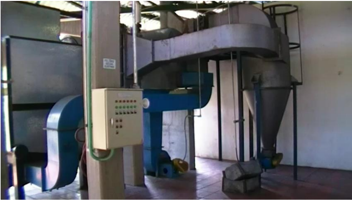
Ilustración 18 Sistema de ciclón de la caldera
