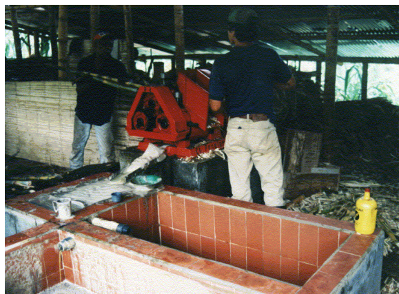
Fotografía 5. Prelimpiador en concreto.
